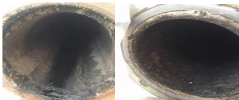
活性污泥引入后管线内部情况，未出现结垢
