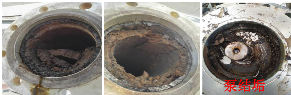
活性污泥未引入时管道内部及泵体结垢严重
