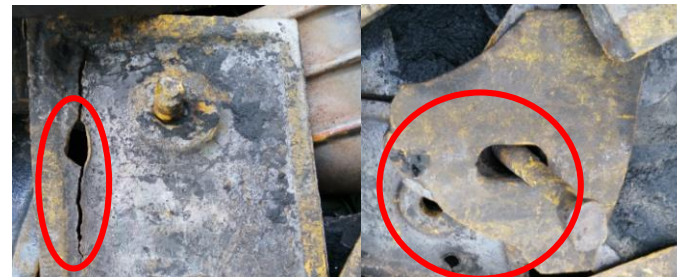
衬板部分脱落、破损
